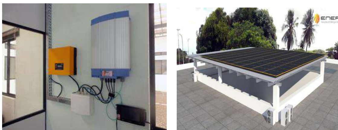
Figura 5 - Instalação do Sistema Solar no CENEA
